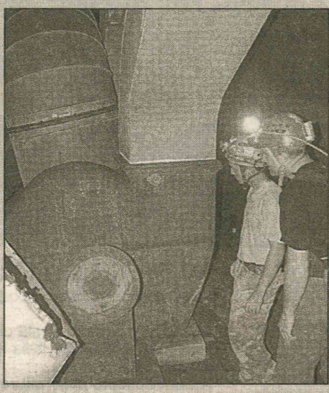
IMPIANTO DI AERAZIONE
